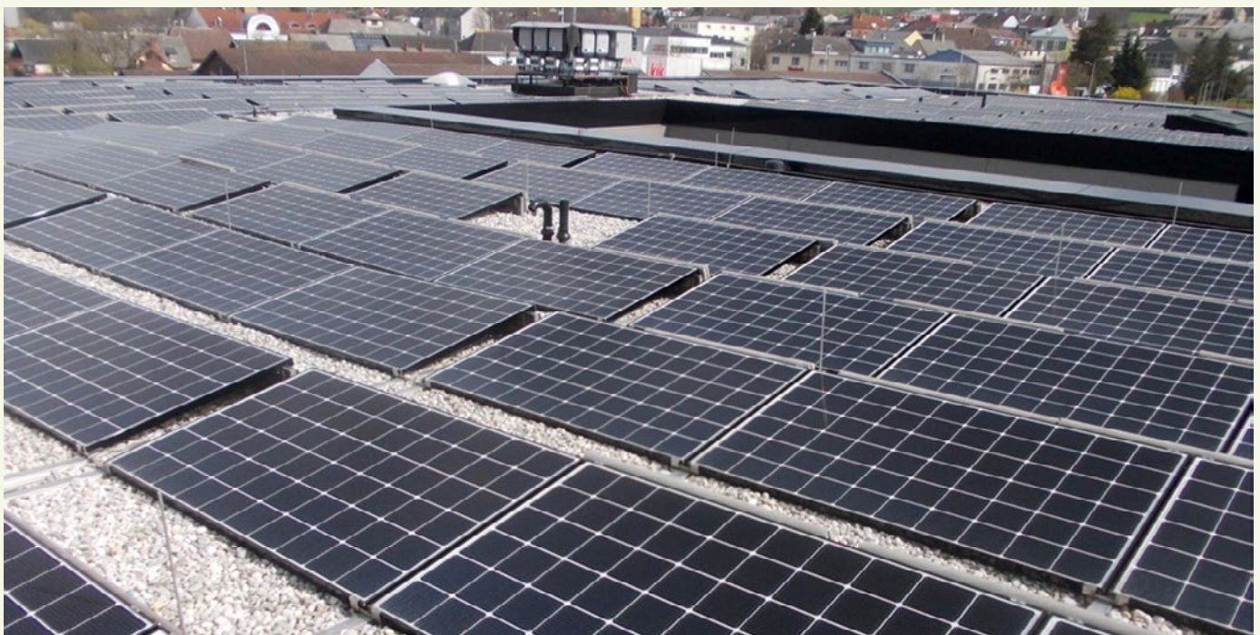
Entwicklung der Photovoltaikanlagen
