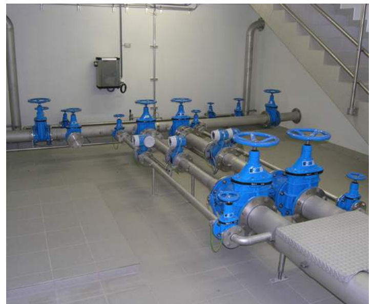
Blick in die Schieberkammer eines Hochbehälters
