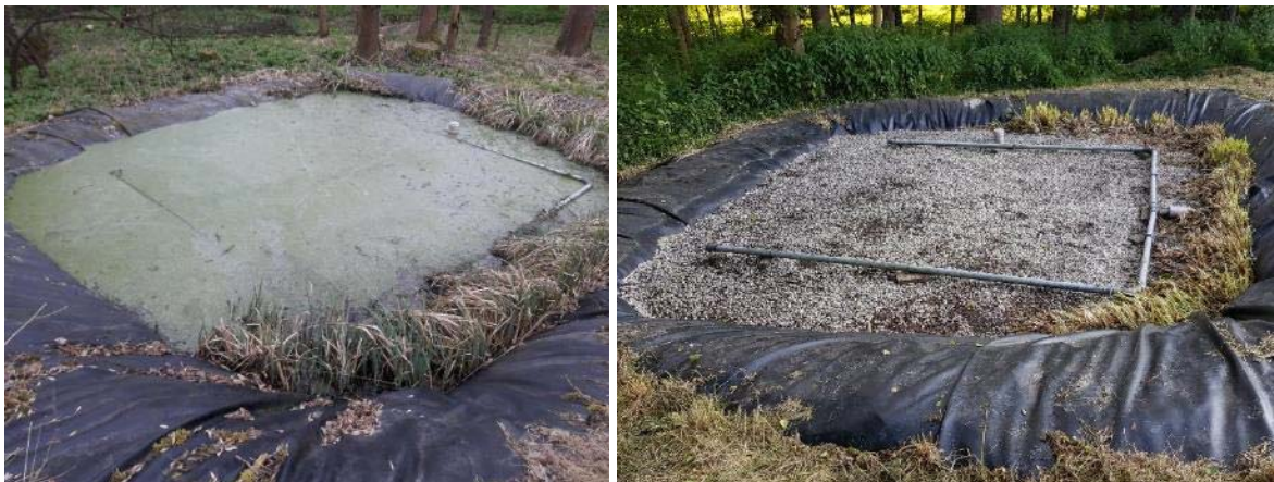
Abb. 32 Zustand des nachgeschalteten Bodenfilters der Kläranlage im März 2023 (links) und nach der Sanierung (rechts)
