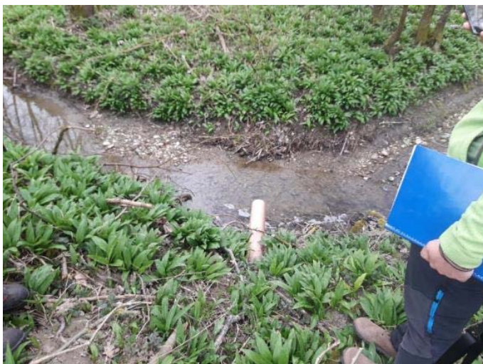
Abb. 25 Drainagerohr mündet direkt in Gewässer
