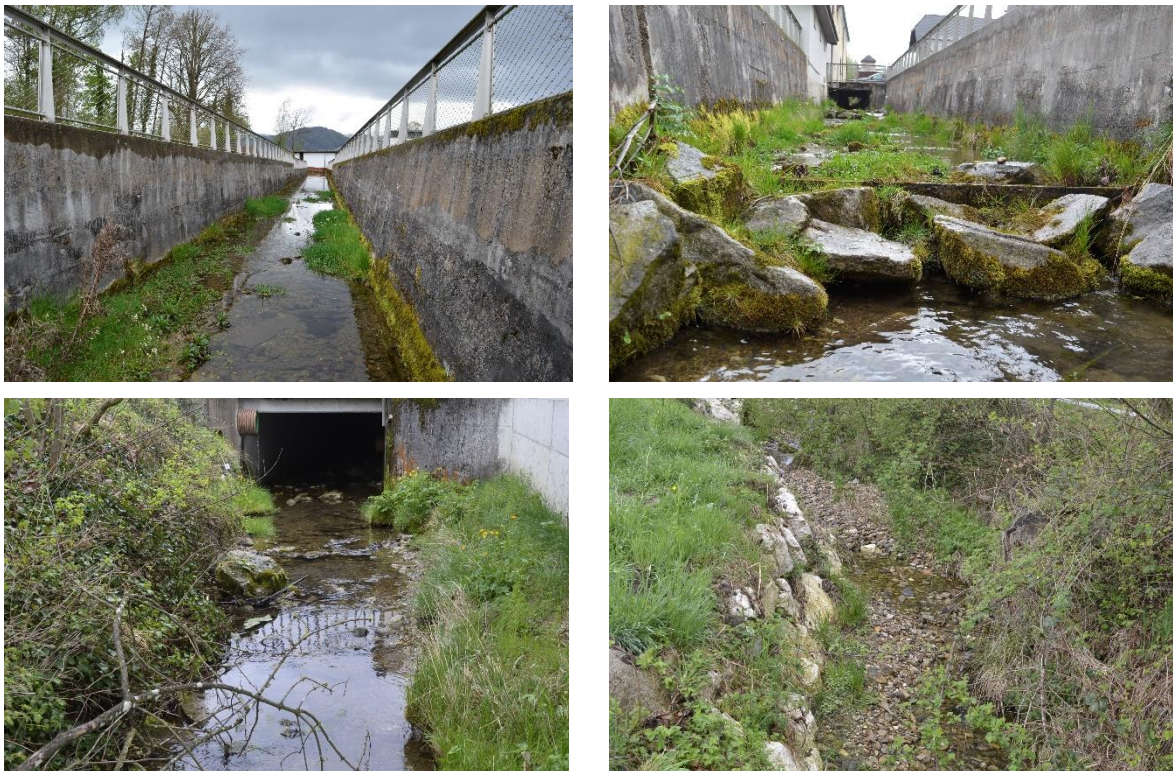
Abbildung 13: Links oben: Segment 1, Unterster stark begradigter rückgestauter Mündungsbereich mit Betonwänden beiderseits rechts oben Ende Segment 1 – Anfang Segment 2, Unterspülte Sohlschwelle im begradigten unteren Bereich mit beiderseitigen Betonwänden; links unten: Segment 4 mit Blick auf Ende Segment 3, Blickrichtung bachabwärts, Bachlauf mit natürlicherer Morphologie und Beginn des unterirdisch geführten Teils; rechts unten: Segment 5, Oberer Bereich, Pendelnder Bachverlauf mit natürlicher Substratzusammensetzung und rechtsufriger Ufersicherung.
