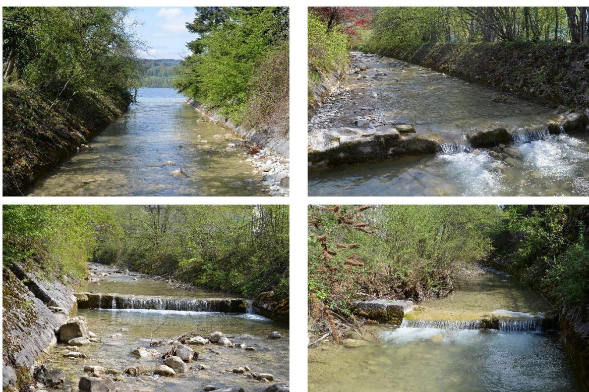
Abbildung 35: Links oben: Segment 1, Stark begradigter Mündungsbereich mit beidseitiger Ufermauer -Blickrichtung bachabwärts; rechts oben Segment 2 Mittlerer Bereich mit beidseitiger Ufersicherung und einer betonierten Sohlschwelle – erschwert fischpassierbar ( \Delta h 15 cm); links unten: Segment 1, Oberer Bereich, Beidseitige Ufersicherung und grobes Substrat mit Sohlschwelle ( \Delta h 20 cm) – erschwert fischpassierbar; rechts unten: Mitte Segment 2, Beidseitige Ufersicherung und betonierte Sohlschwelle ( \Delta h 17 cm) – erschwert passierbar vor Weidenvegetation.
