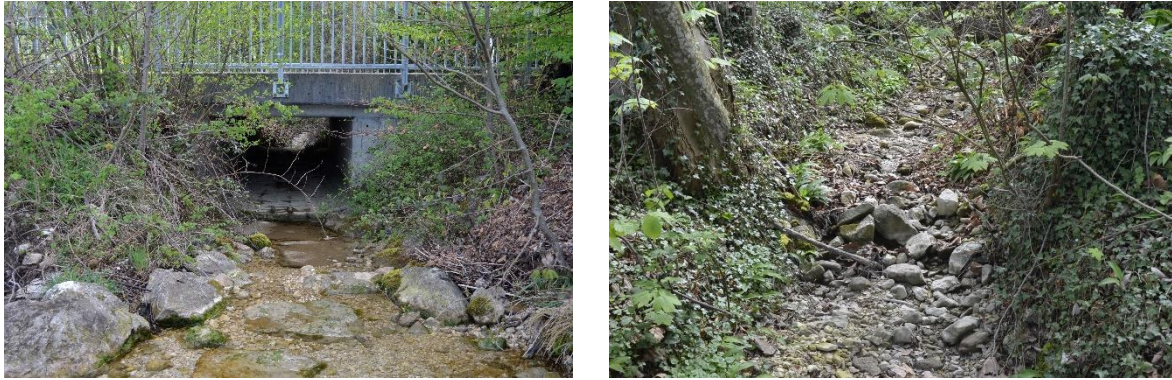
Abbildung 31: Links: Segment 1, Unterster betonierter/gepflasterter Bereich unter Straßenbrücke – kein Wasser; rechts oben Segment 2 Mittlerer Bereich mit natürlicher Substratzusammensetzung und Vegetation – kein Wasser.
