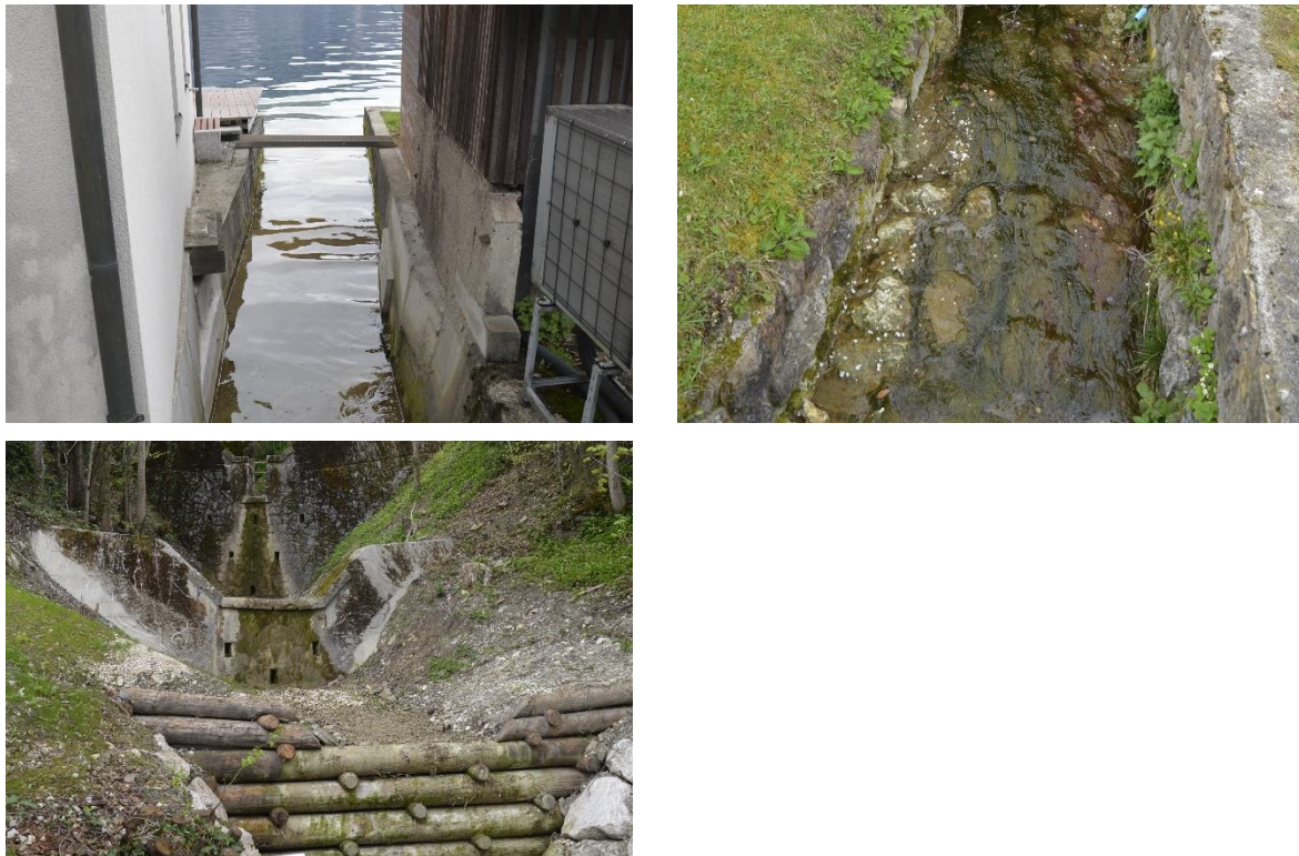
Abbildung 21: Links oben: Segment 1, Unterster Bereich, betonierter stark begradigter Mündungsabschnitt bachabwärts der Unterführung unter der Straßenbrücke; rechts oben Segment 1 Mittlerer Abschnitt mit gepflasterter Sohle und hart verbautem Ufer- nicht fischpassierbar; links unten: Segment 3, Oberster Bereich, 3 große Geschiebesperren ( \Delta h > 150 cm) -nicht fischpassierbar, fast kein Wasser.
